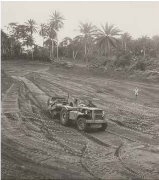
Sans titre [Travaux de terrassement d'une route vers Dabou (Côte d'Ivoire)], 1951 Donation François Kollar, Médiathèque de l'architecture et du patrimoine
